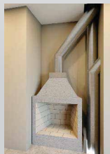
Sistema de exaustão semicoletivo
